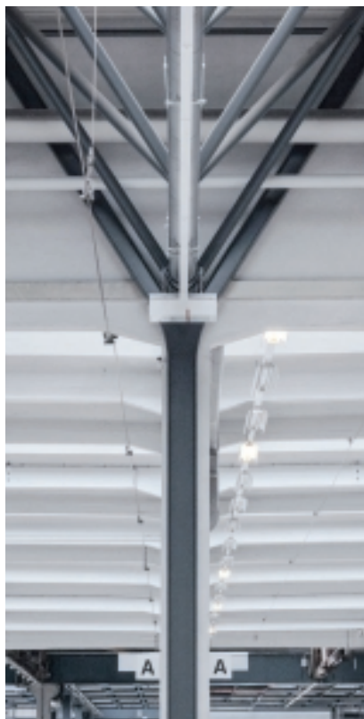
Integration Bestandesleuchten in der grossen Werkhalle.
