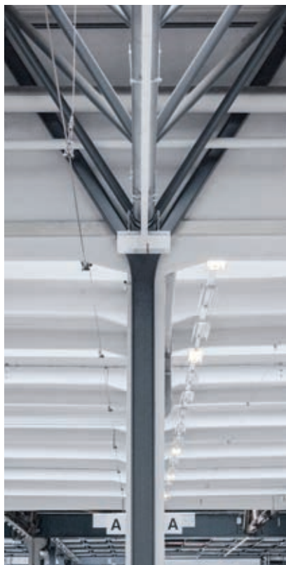
Integration Bestandesleuchten in der grossen Werkhalle.
